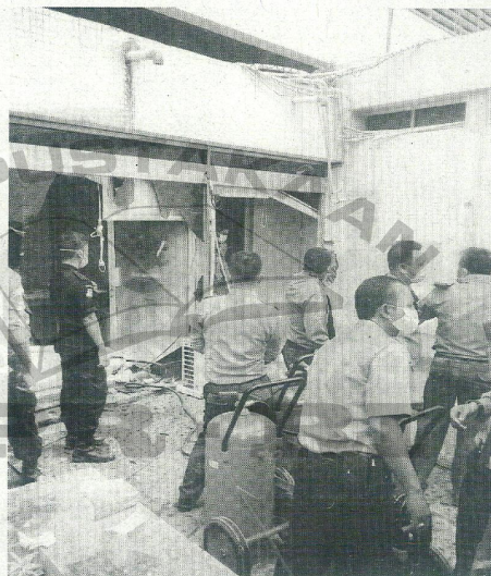
Proses pemadaman ruang AHU yang terbakar.
